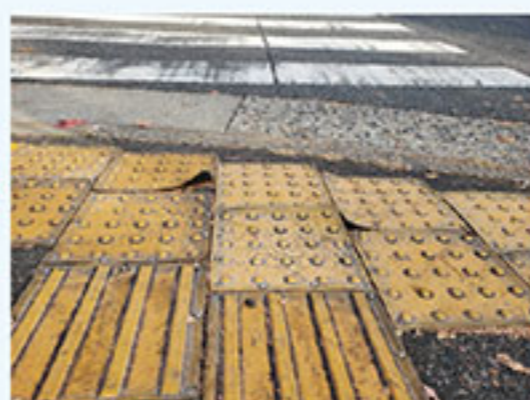
< 杵ヶ池通りの危険な点字ブロック >
